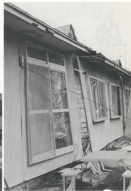
▲集合煙突が倒壊、床や壁も 破損した住宅（緑町）
