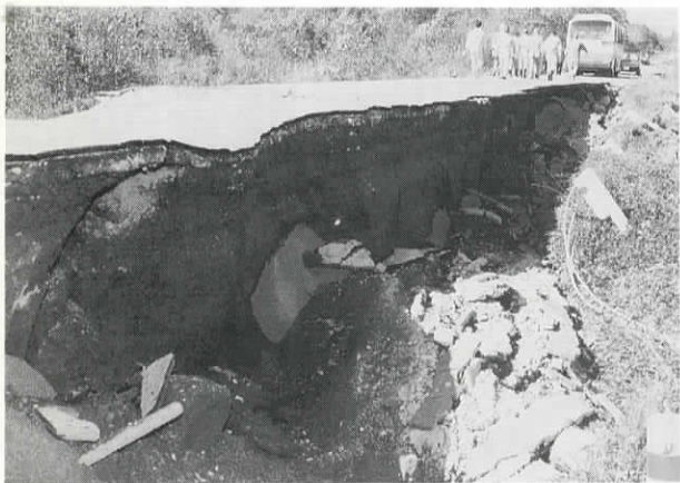
▲崩壊した町道茶志骨西4線
