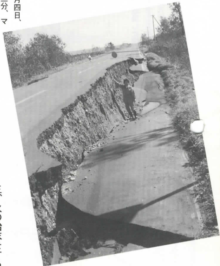
東方沖地震による道路崩壊。いつ起こるか分からない大地震…
