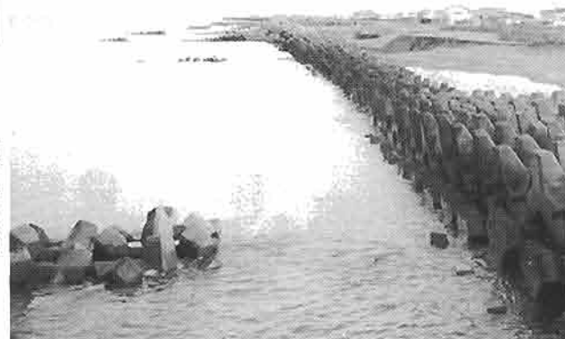
浸食が進む標津町の前浜
