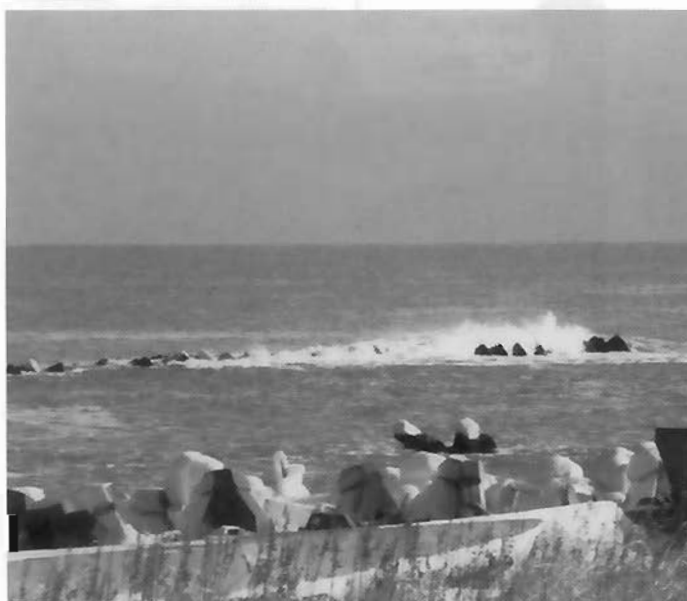
沈下した離岸堤
