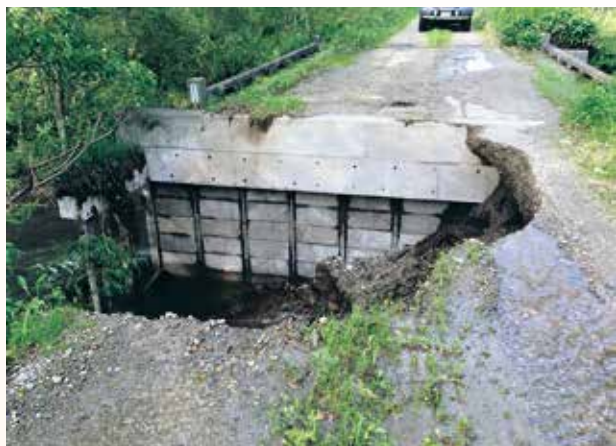
西北標津川上西5号橋の被害状況
